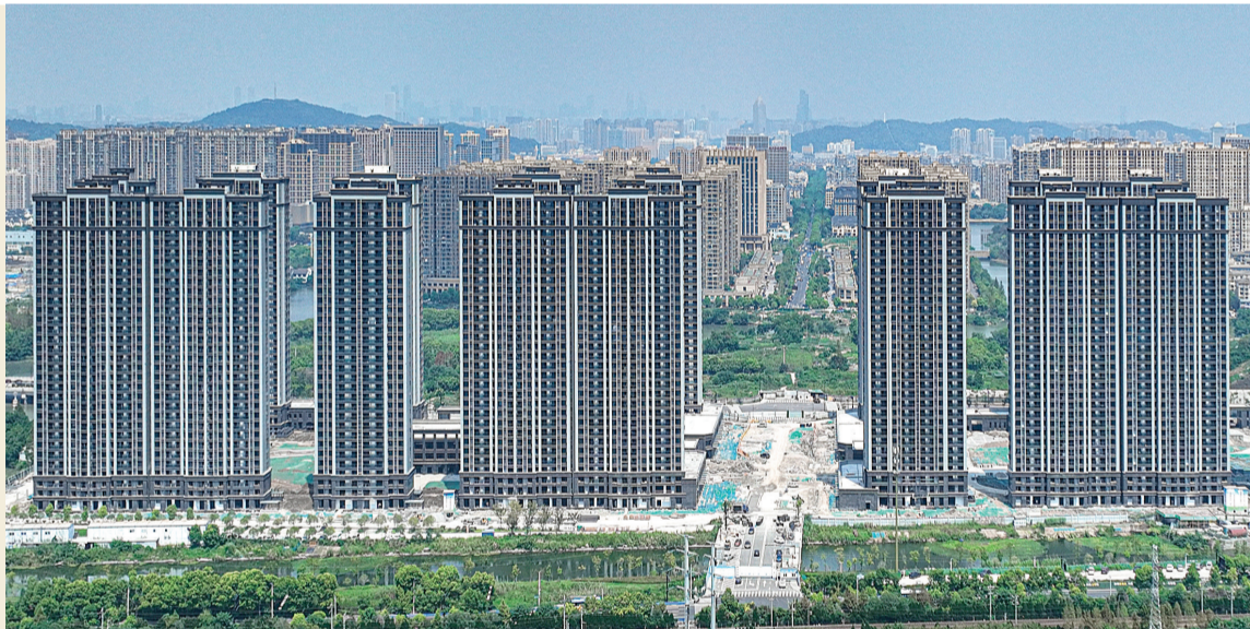
所前镇城南村城中村改造安置房项目于2019年11月开工建设,占地面积260亩。目前,安置房主体已基本建成,整个工程预计可在2023年全部完工。 记者 周煜程 摄
