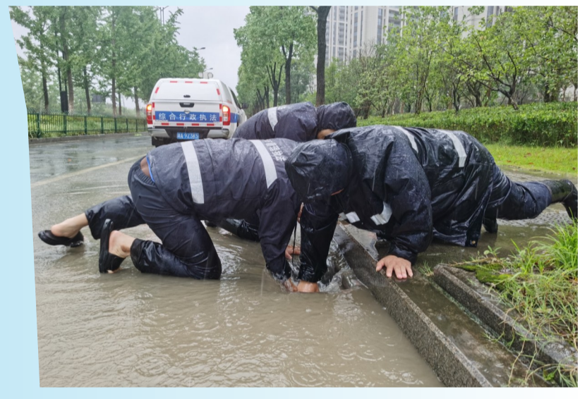
风情大道广东安置房门口慢车道雨水口树叶等杂物堵塞导致积水,蜀山城管中队队员撬起井盖,徒手扒掉堵塞物确保排水。
