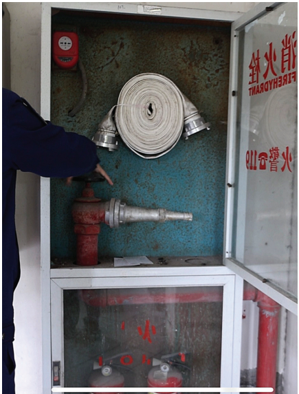
消防栓难以正常开启
