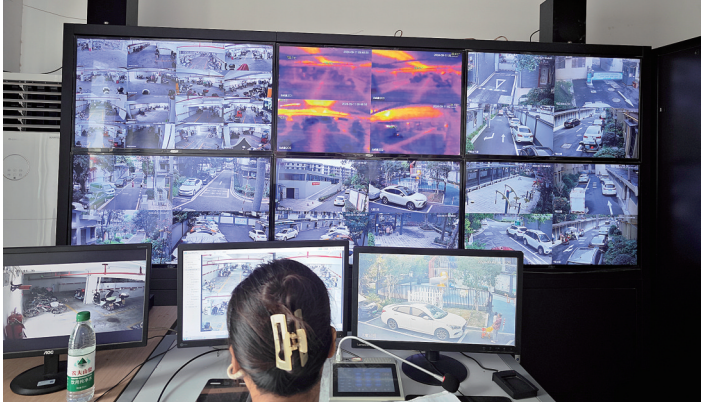
崇三小区电动自行车停车库热成像视频监控
